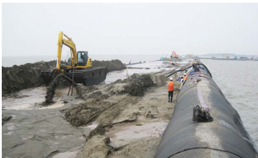
> 施工平台和土工管袋最后将嵌入在一块填海区内将亭武开发区的面积扩大2倍
