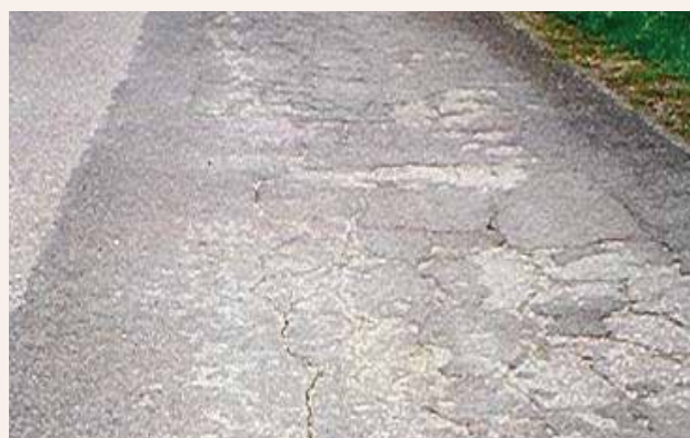
旧道面维修前，路面典型的破损情形
